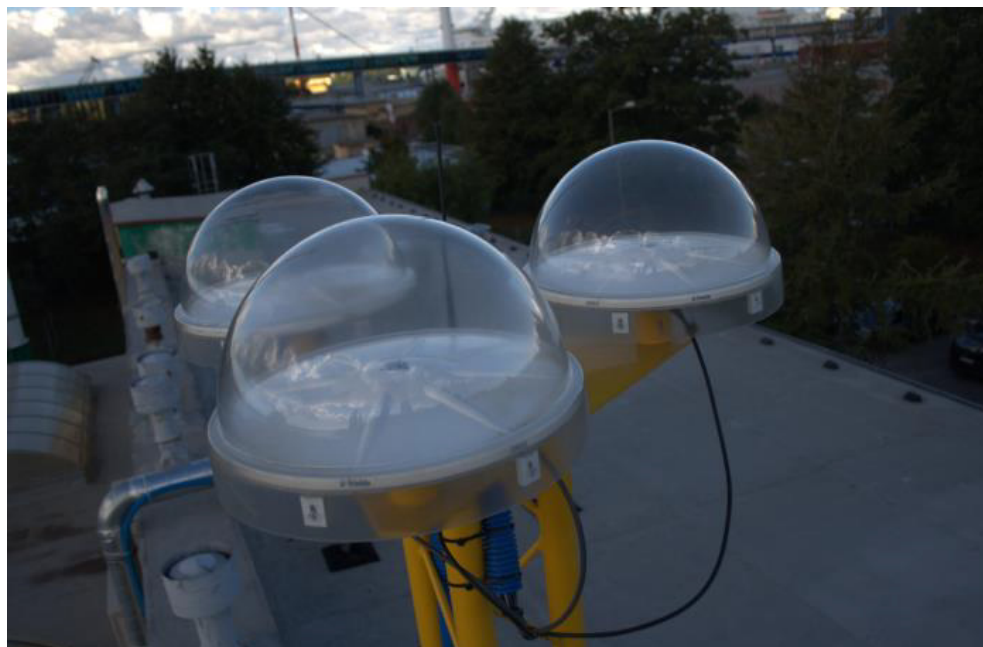
Rys. 3. Anteny pomiarowe GNSS Morskiej Stacji Referencyjnej RTK
